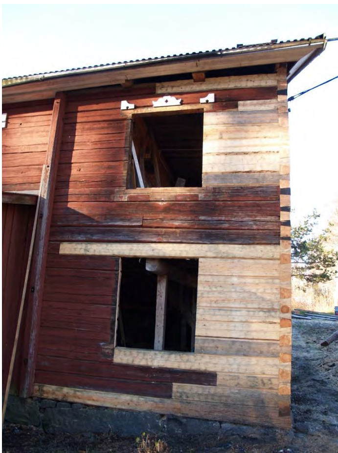
2015-11-11: Avståndet från grundstenen i hörn BC upp till en bräda i takfoten är 5,25 meter. Nästa år ska knuten mätas igen för att dokumentera hur mycket stommen har sjunkit ihop.
