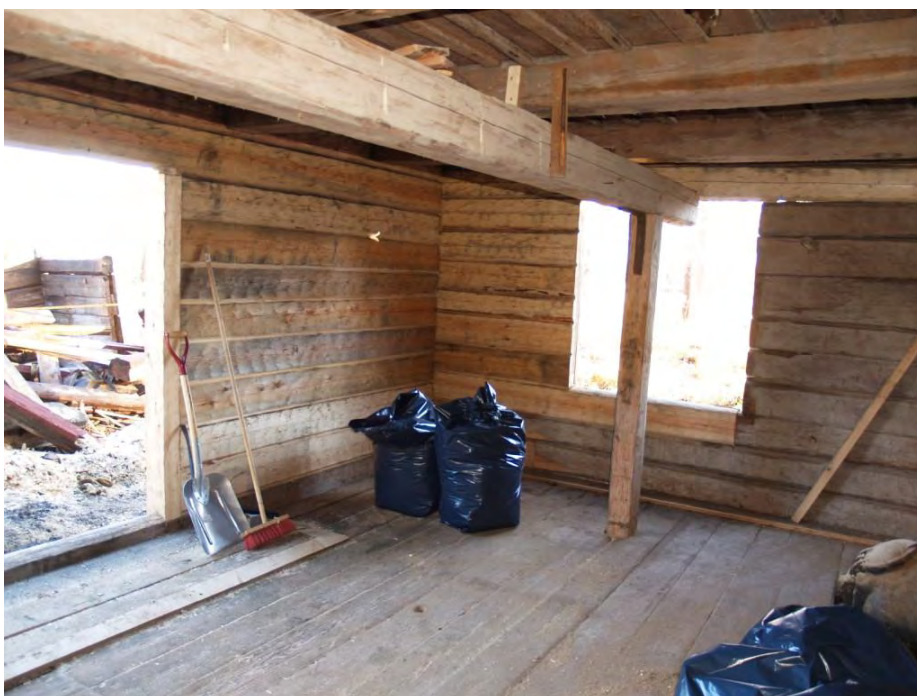
2015-11-11: Invändigt har nya golvplankor lagts in precis innanför dörren eftersom de gamla var skadade.
