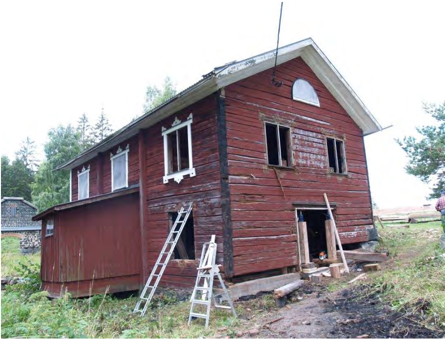
2015-08-12: Betongen i hörn BC ska tas bort.
