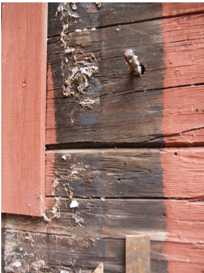
2015-09-02: Stommen hade strukits med en becksörja och är fortfarande fet. Det är möjligt att det är den tilltappande smörjan som har bidragit till rötskadorna på B.
