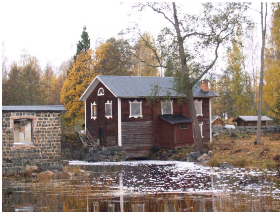
2014-10-16: Det grå fältet är nytt timmer som tidigare använts för att sätta igen öppningen mot vattenhjulet. Av någon anledning släpper färgen där.
