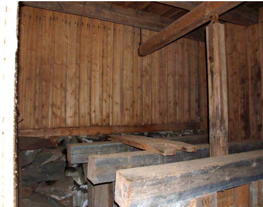
2014-10-16: Vägg A, och även insidan av D, har klätts med en lockpanel inne i hjulhuset. Panelen måste lossas om stockarna ska kunna bytas.
