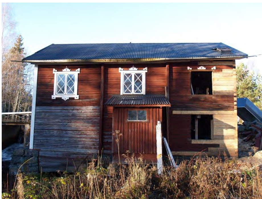
2015-11-11: Långsida C. Nu återstår att byta hängrännan, mura upp skorstenen och sätta in fönster.
