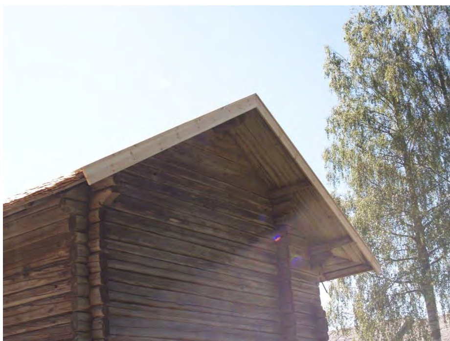
2015-07-03: Nya vindskivor och vattbrädor har satts upp på gavlarna medan nockbrädorna byttes 2014, samtidigt som det främre takfallet lades om.
