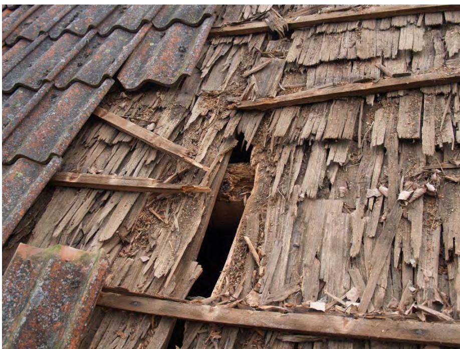
2015-09-01: En ordentlig läcka hade orsakat röta i bakomliggande takås.
