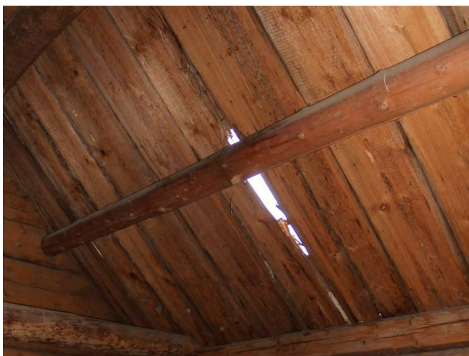
2015-09-01: På insidan ser åsen fin ut, men rötan har gått in i stocken ovanifrån. Det fanns även en fläck på andra takfallet där fukt gått igenom vid brytningen, men det är oklart hur stor den skadan är.
