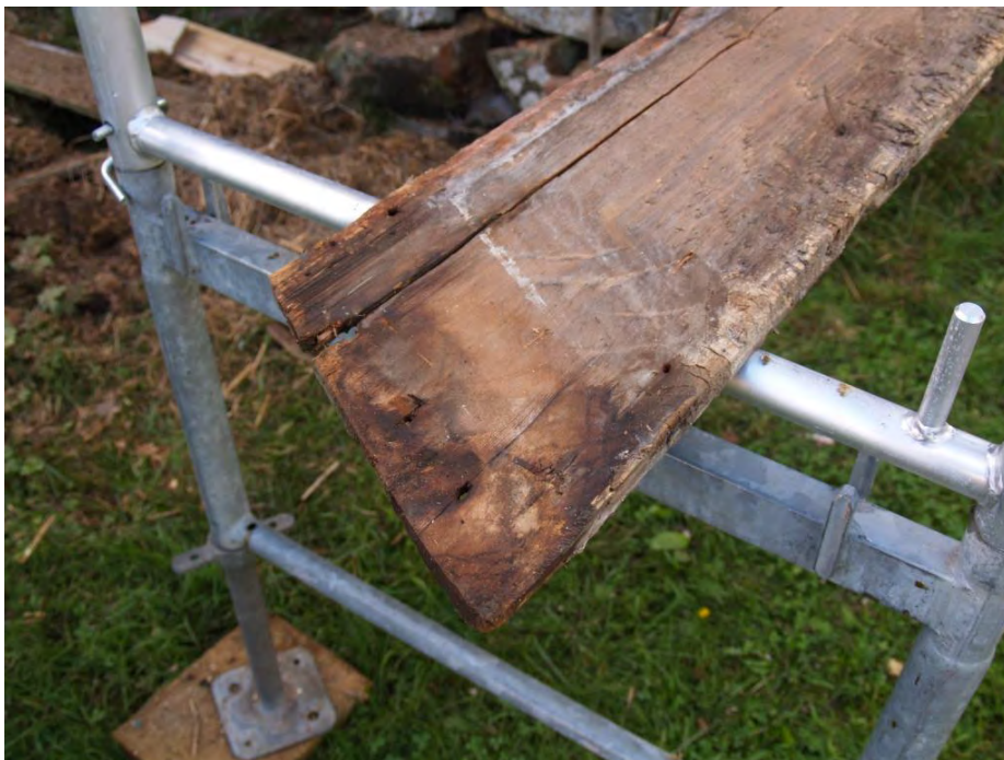
2015-09-04: På en av vindskivorna på gavel A syns huggspår där man anpassat vindskivan efter bakomliggande ås.
