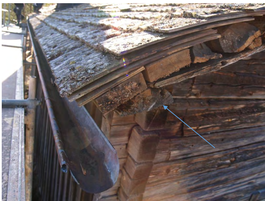
2015-04-21: Spånen ligger i tre lager. På takutsprånget ligger plywood i stället för korta spån, och sedan två fullånga spån. Ett grovt vågbord bär takfoten.
