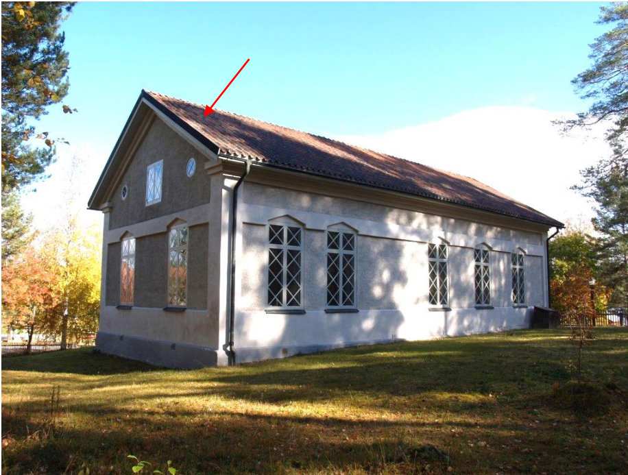
2014-10-03: Det har under en tid saknats takpannor, vilket gjort att undertaket skadats.
