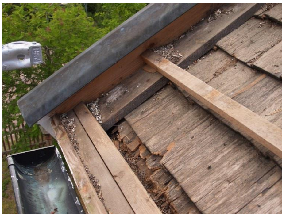
2016-07-05: Detalj av spåntak med en äldre vattbräda. Spånen har kapats av nedtill för att ge plats åt tegeltakets takfot. Det är en risk att läckande vatten rinner in i takfoten där spånen huggits av, vilket troligen är orsaken till den skadade takfotsbrädan på D mot hörn CD.
