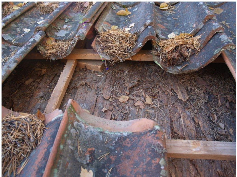
2014-10-03: Närliggande träd släpper barr och löv som åker in under takpannorna.
