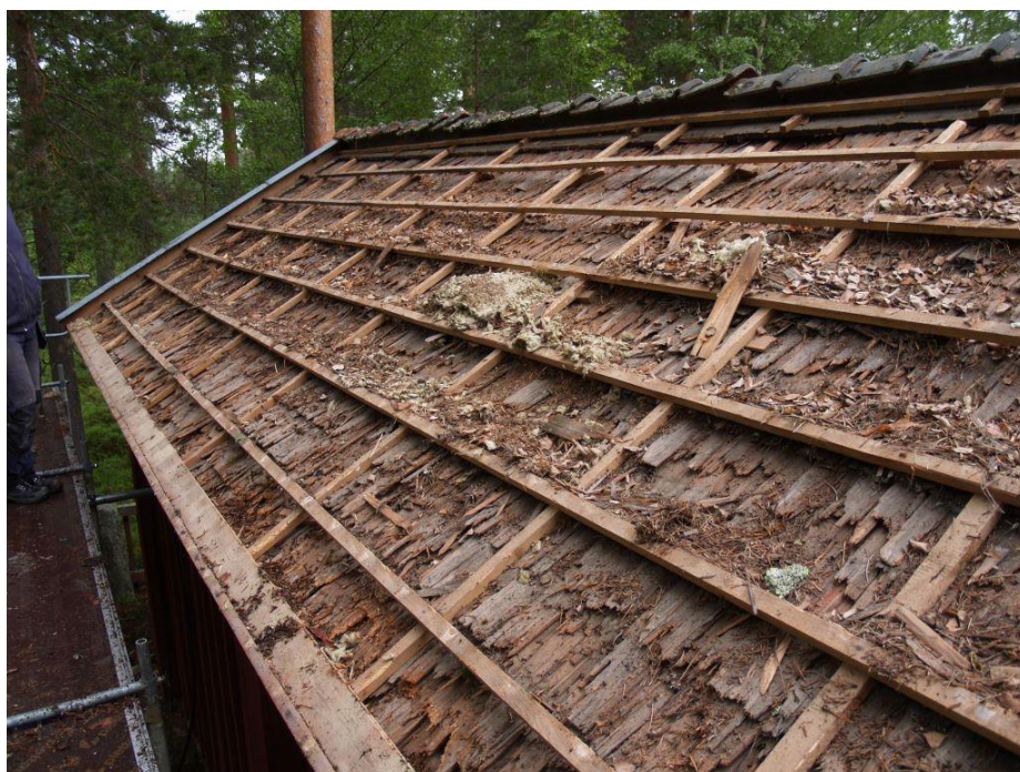
2016-06-21: Spåntaket på likboden/uthuset efter att teglet tagits bort. Spånet är dåligt men det finns inga stora håligheter som skadat takkonstruktionen.
