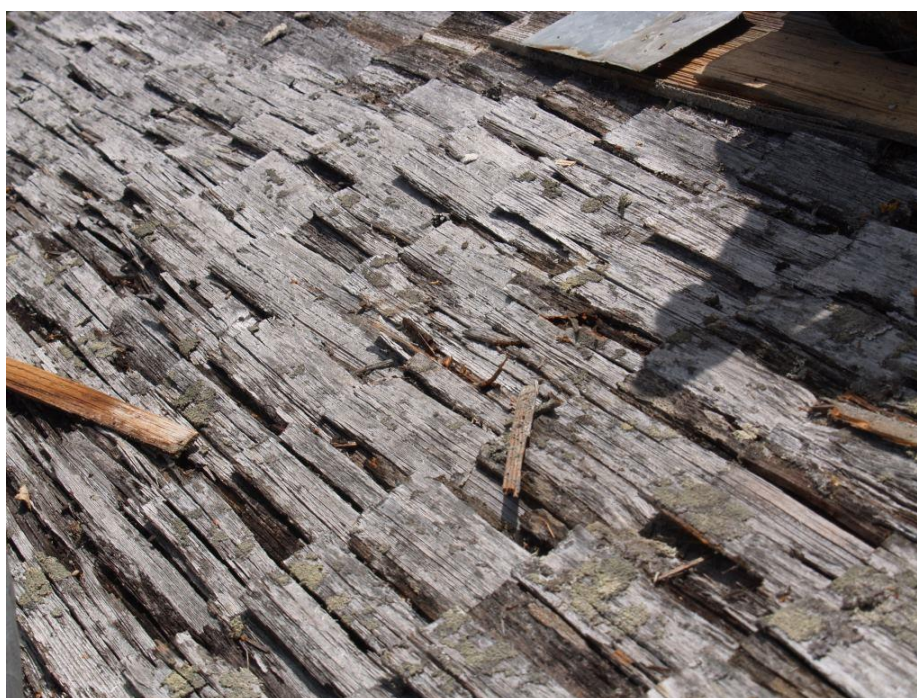
2017-05-31: Eftersom det inte fanns någon ställning dokumenterades inte det befintliga spåntaket tillräckligt. Vi kan se att det är genomgående rötskador i de övre spånen.
