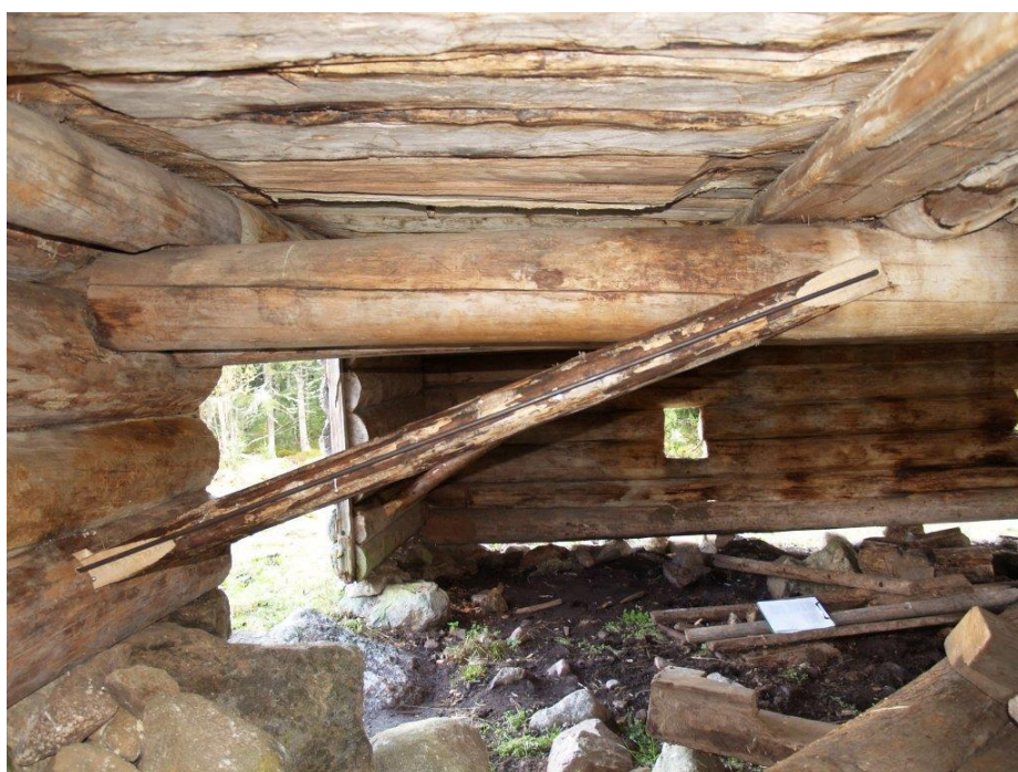
2020-10-08: Slutbesiktning Nya trästagg. Det gick inte att hitta en bra infästning för stagen som skulle klara dragkrafterna och därför tillfördes ett dragjärn parallellt med trästaget.
