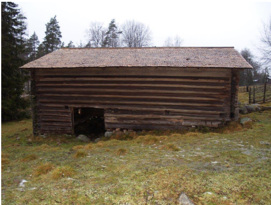
2019-11-22: Fäxet rör sig och glipor har uppstått mellan timmerstockarna samtidigt som stenstöden ramlat undan under syllarna.
