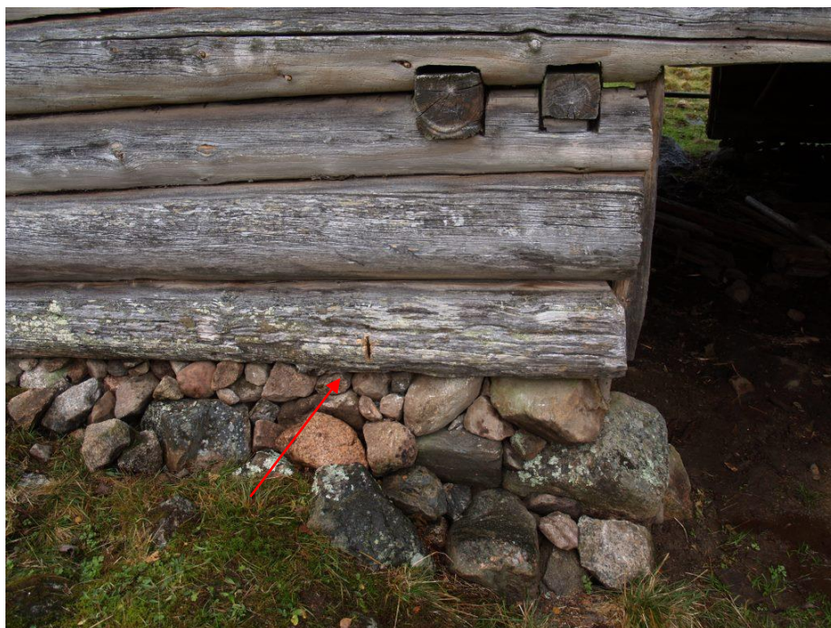
2020-10-08: Slutbesiktning Stengrunden har kompletterats efter att stommen dragits ihop. Järnstagets genomföring genom stocken har markerats med röd pil.
