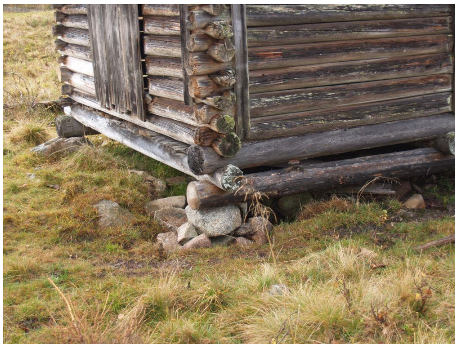
2020-10-08: Slutbesiktning En bredare bas av sten har byggts så att det går att ställa större hörnstenar på denna.
