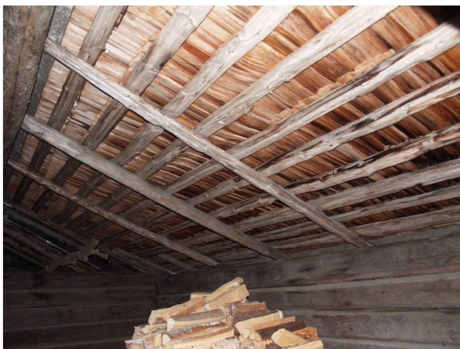
2019-11-22: På insidan syntes fuktgenomslag och svarta märken där rötan hade gått igenom spånen.
