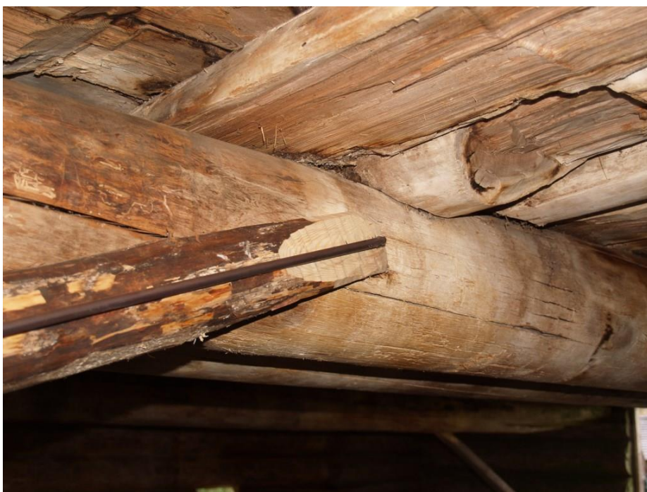
2020-10-08: Slutbesiktning Järnstaget har en vinklad ände med spets som har slagits in i bärlinan.
