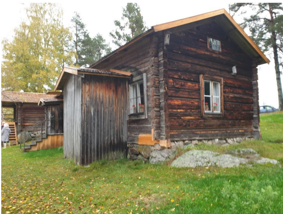
2020-10-07: Slutbesiktning Vädret gör att fotot väl visar var fukt går in mot stomme och panel. Marknivån kring farstukuren ska sänkas genom grävning.
