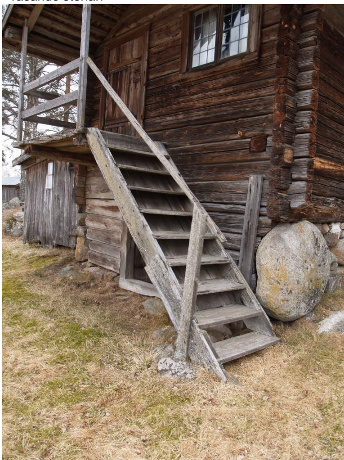
2020-04-08: Trappan var skadad med sprickor i plansteg och rötskador. Virket stod mot marken nedtill och hade lagats tidigare.
