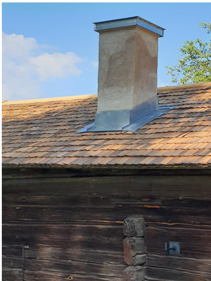
2020-06-22: Skorstenens nederdel är lagad med ett kalkcementbruk från Weber: Weberbase 224 puts- och murbruk C.
