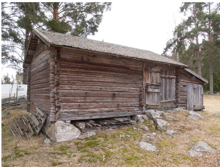
2020-04-08: Spåntaket på logen hade skadats av löv och barr från intilliggande träd och skulle behövt läggas om inom 5-10 år. Äldre foton visar att träden inte fanns där tidigare utan tillåtits växa upp under 1900-talets senare del.
