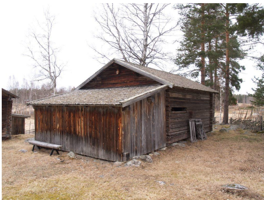
2020-04-08: Halmsvalen har en flack lutning och fukt har trängt igenom spånen så att fuktrosor blivit synliga på undersidan.
