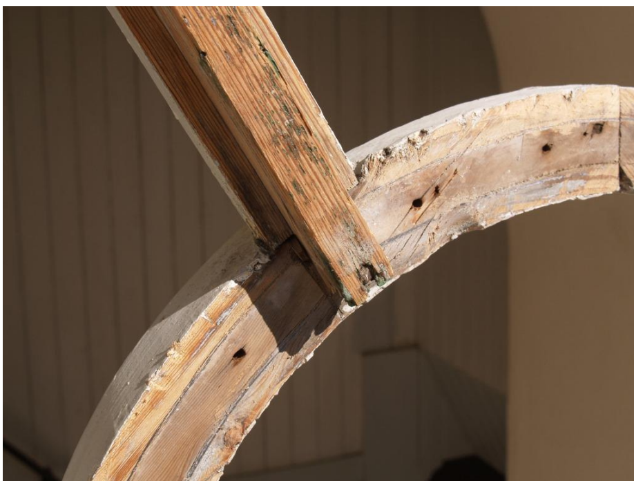
2019-04-15: De yttre delarna, som bågarna kläms fast mellan, består av lösa lister som spikats på den invändiga träformen.
