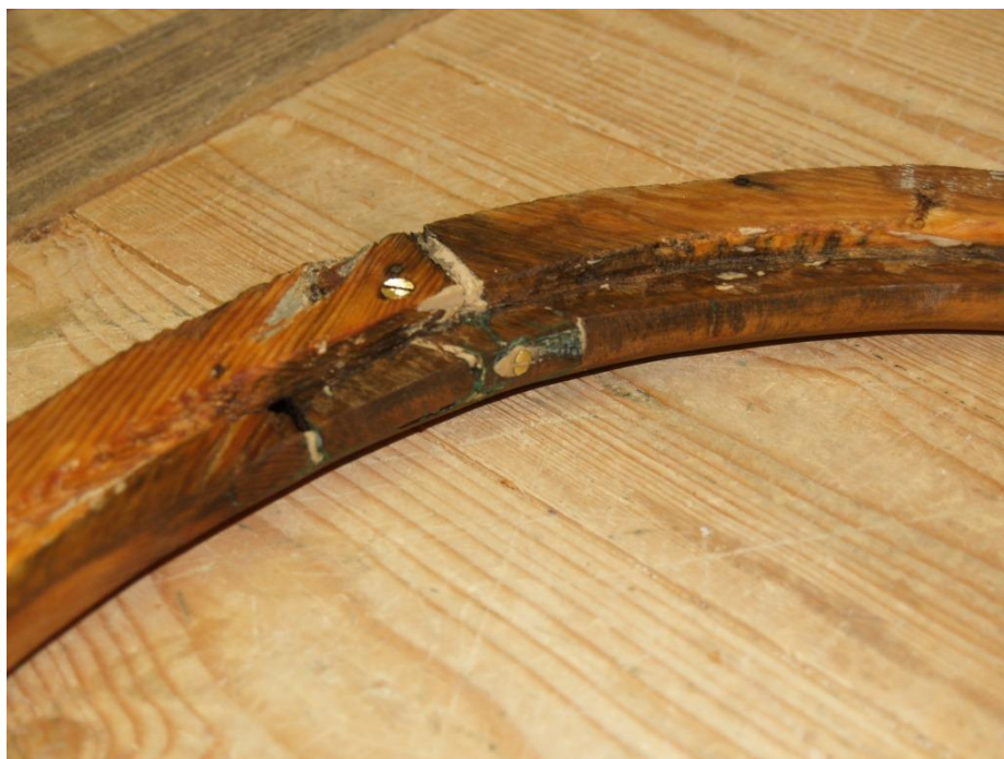
2019-04-24: Fönstret hade genomgått restaureringar tidigare då sammanfogningen av delarna hade förstärkts med spårskruv.
