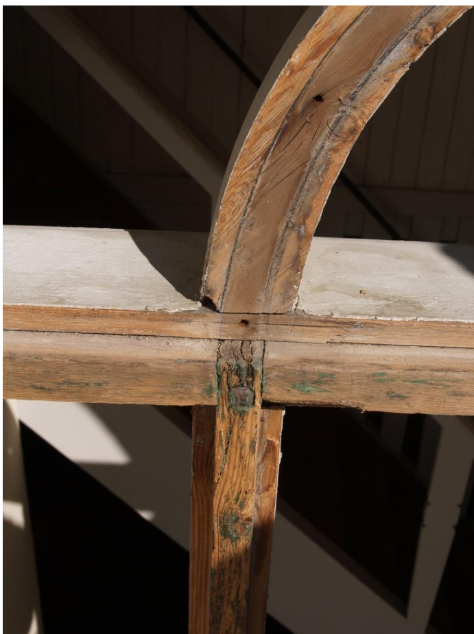
2019-04-15: Listerna hade skador och byttes ut. Spikarna återanvändes inte, utan ersattes med skruvar eftersom spikarna kröp ut ur spikhålen. Listerna är lösa. Eftersom de håller glaset behöver de sitta stadigt.
