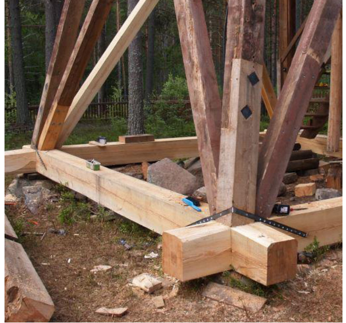
Den nya grundramen har kommit på plats och övriga delar av stommen är renoverade.
