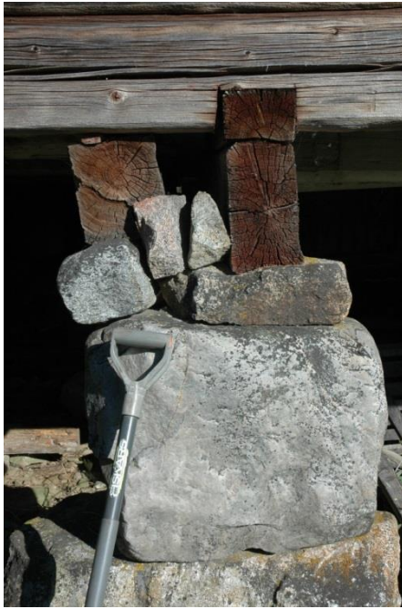
Figur 11. Detalj av bärande åsar och stenpelare under stallbyggnadens västra fasad. Foto: Daniel Olsson, Länsmuseet Gävleborg 2016-08-23.
